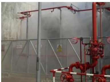
防火システム
